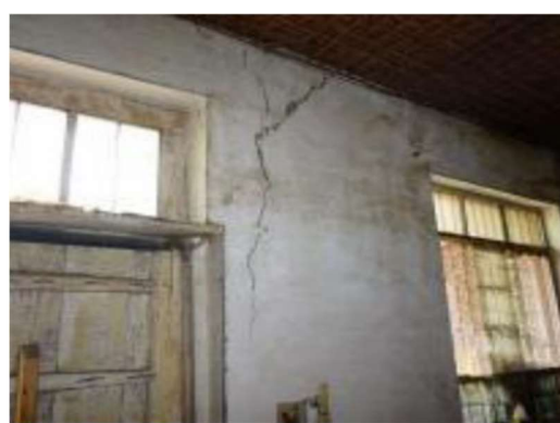
图 D-4 墙体裂缝
