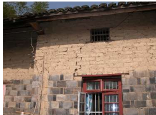
图 C-50 下砖上土坯墙承重房屋的震害
