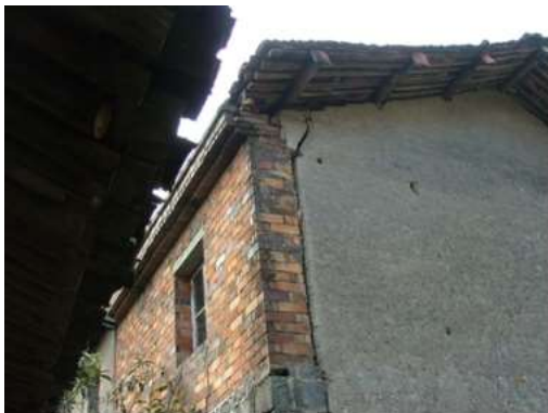
图 C-49 砖墙与土墙间通缝拉脱
