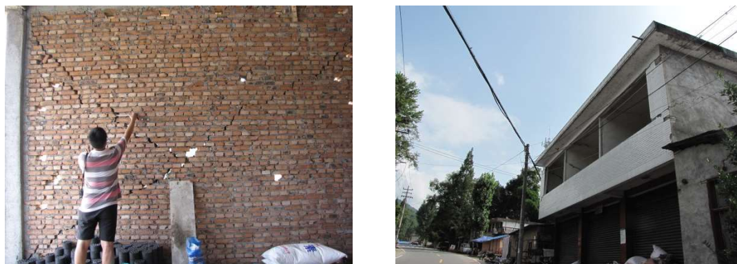
图 C-25~图 C-26 地震中底框房屋的破坏现象，因扭转而加重震害
