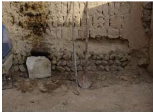
图 D-10 生土墙体墙根部剥蚀削弱
