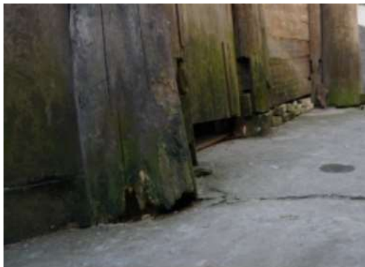
图 D-9 木柱柱脚腐朽
