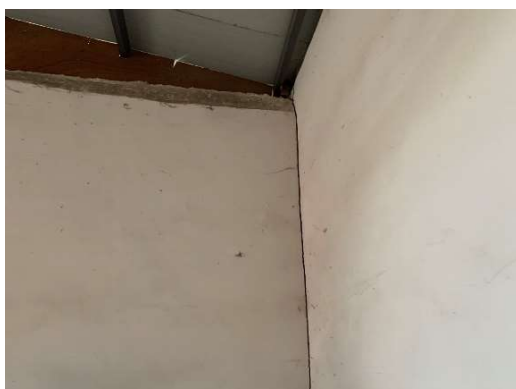
图 D-3 墙体交接处通缝
