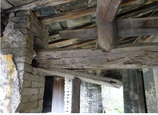
图 D-11 木构件劈裂、局部糟朽
