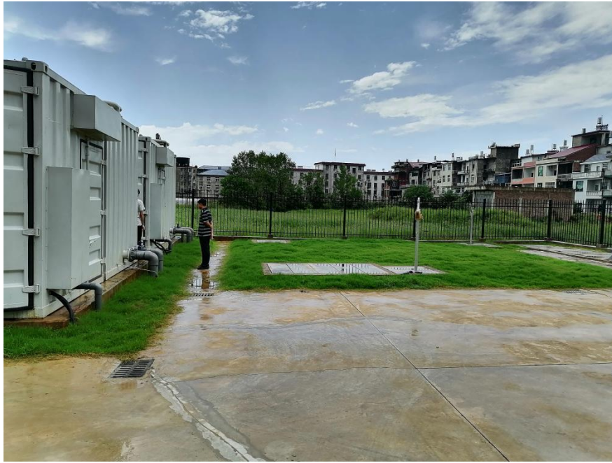
梓埠镇污水处理站
