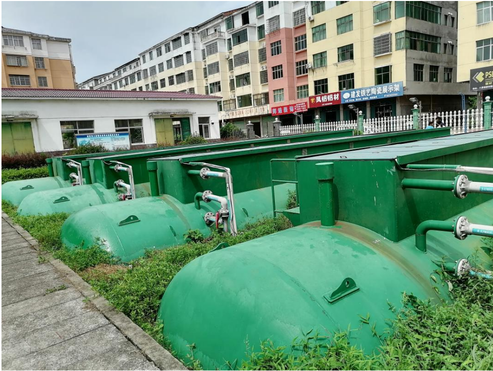
八景镇污水处理站
